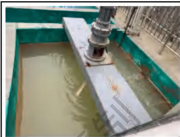
一级反应沉淀池--1格反应池
