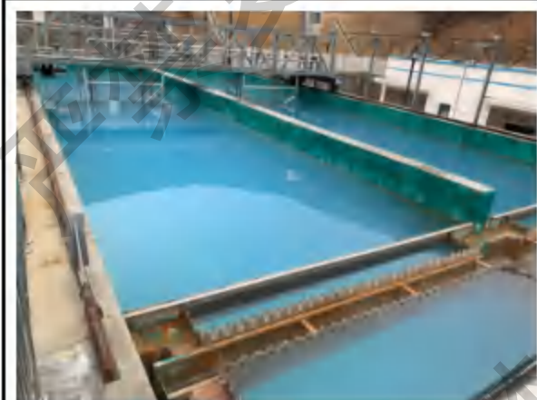
一级反应沉淀池--沉淀池
