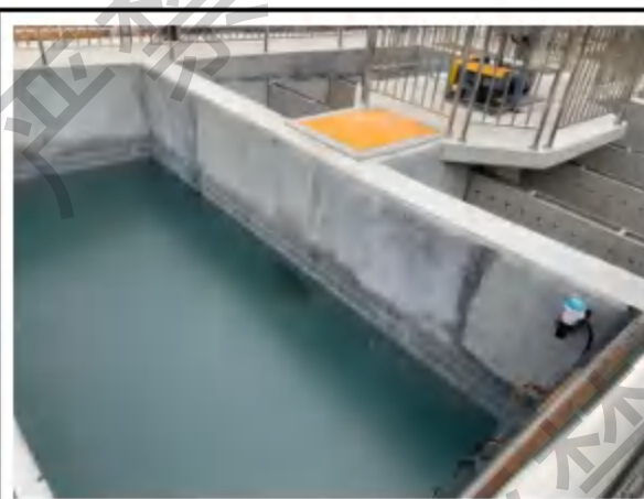
二级反应沉淀池-沉淀池
