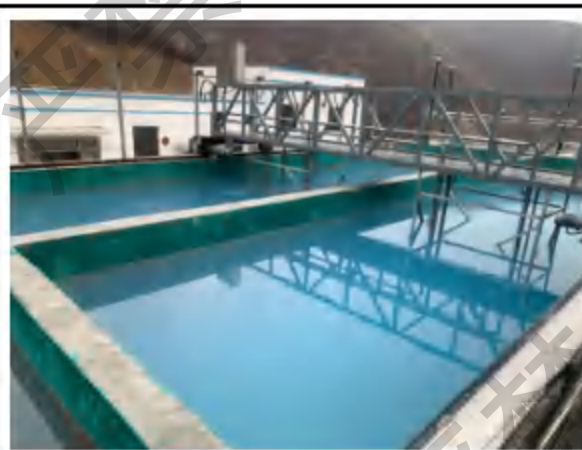
一级反应沉淀池--沉淀池
