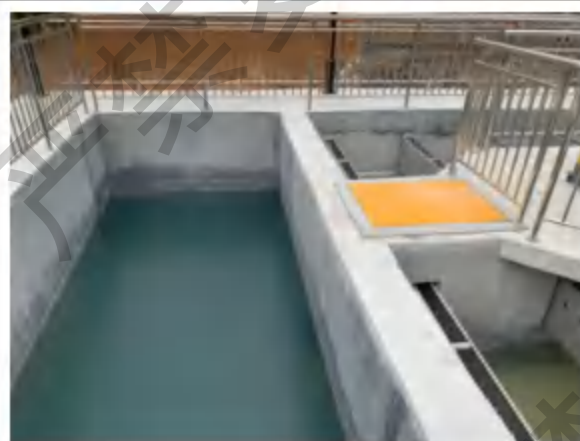
二级反应沉淀池-沉淀池
